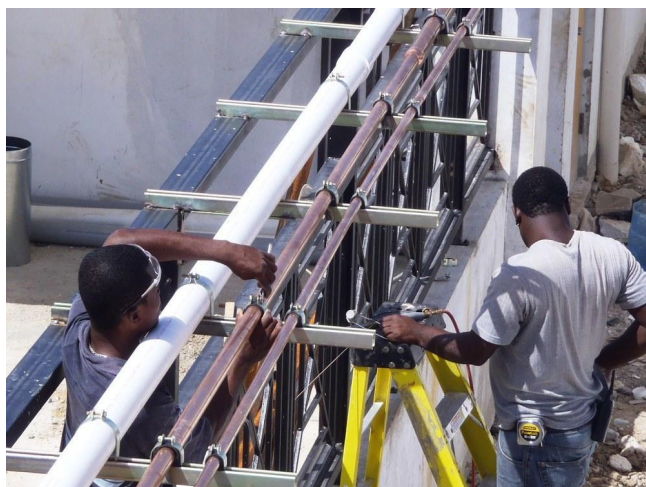
Figura 5a: MGPS instalado à superfície*
