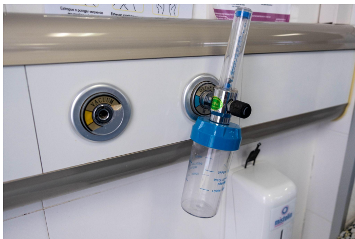
Figura 3a: Saída de oxigénio montada na parede (abastecida por distribuidor ou MGPS diretamente da estação de oxigénio)
