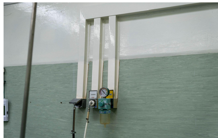
Figura 3b: Saída de oxigénio montada na parede (abastecida por distribuidor ou MGPS diretamente da estação de oxigénio)
