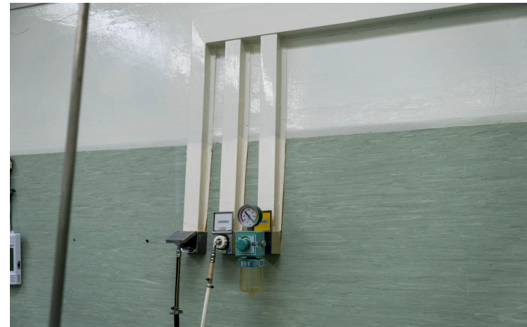
Figure 3 b : Sortie d'oxygène murale (alimentée par le collecteur de cylindres ou le SDGM directement de la centrale d'oxygène)
