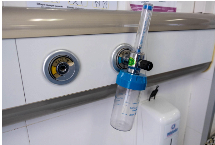
Figure 3a : Sortie d'oxygène murale (alimentée par le collecteur de cylindres ou le SDGM directement de la centrale d'oxygène)
