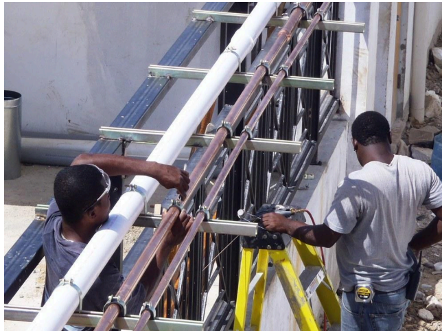
Figura 5a: MGPS instalado à superfície*
