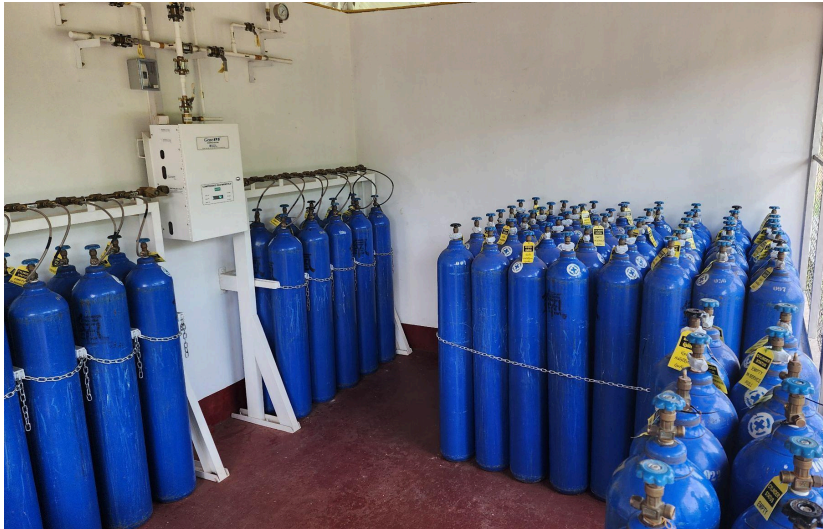
Figura 2a: Distribuidor de cilindros e armazenamento fixado com correntes
