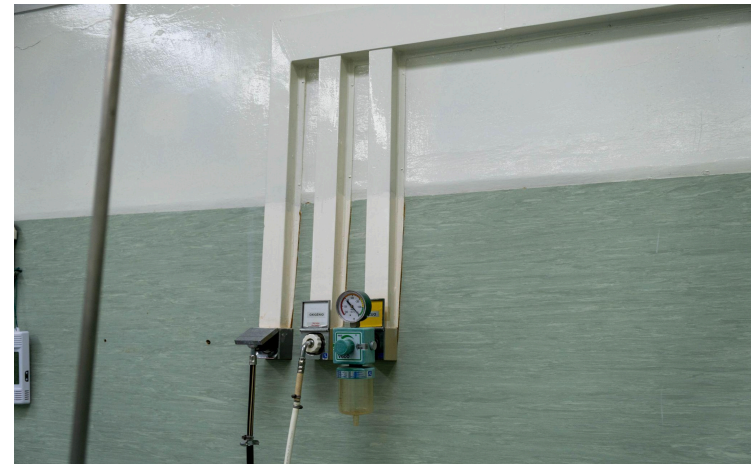
Figura 3b: Saída de oxigênio montada na parede (abastecida por distribuidor ou MGPS diretamente da estação de oxigênio)
