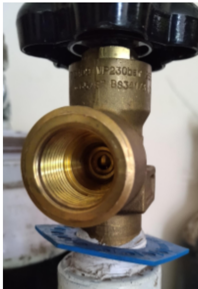
Repare na marca "BS341".
