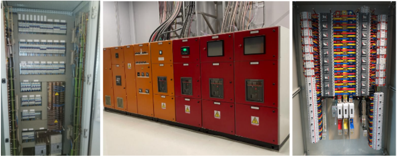
Figure 6: Exemples de cabinets électriques bien conçus dans le cadre du travail de BHI
